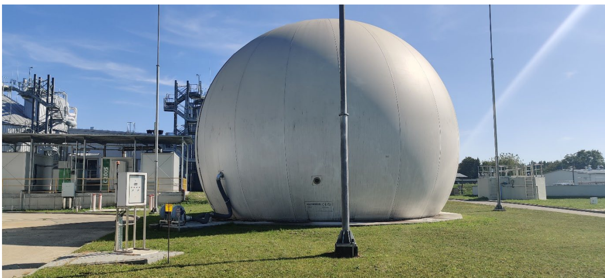
Zbiornik biogazu ob. nr 21b
