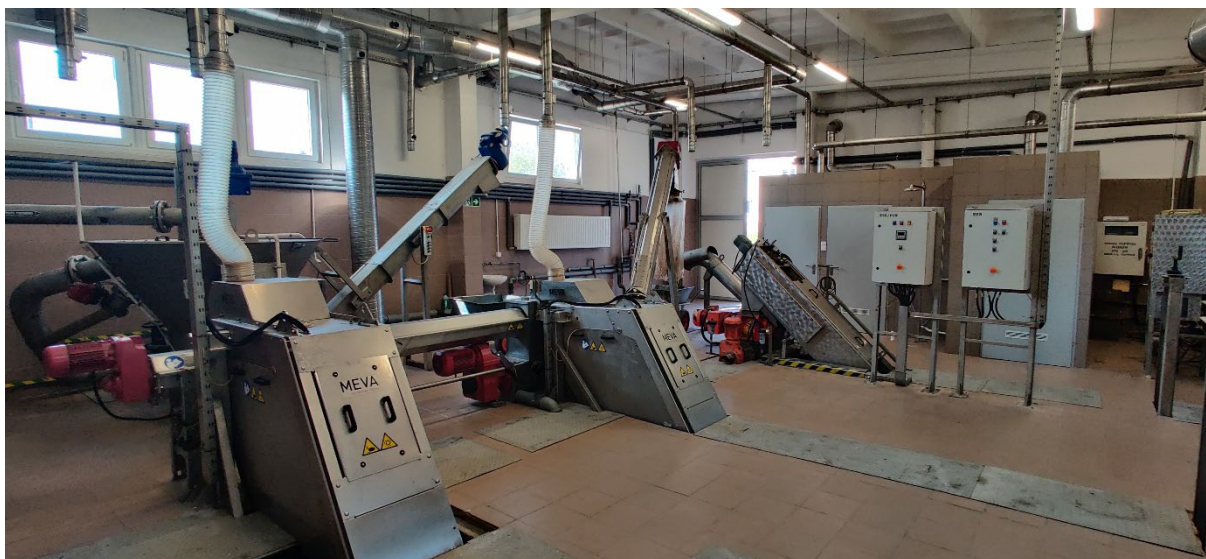
Urządzenia instalacji technologicznej w budynku krat ob. nr 4
