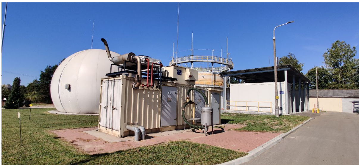
Agregat kogeneracyjny ob. nr 21d
