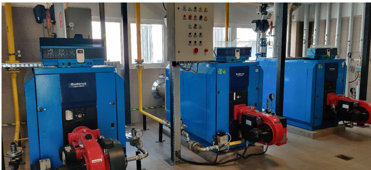
Kotłownia gazowa i biogazowa w ob. nr 15
