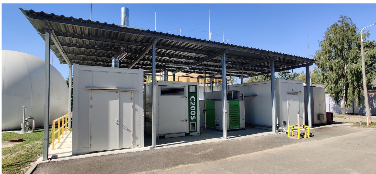
Instalacja uzdatniania biogazu wraz z Mikroturbią ob. nr 20
