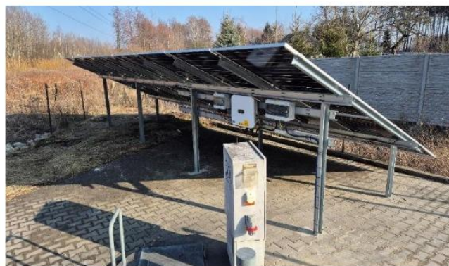
Farma fotowoltaiczna na przepompowni ścieków – przy ulicy Arynowskiej
