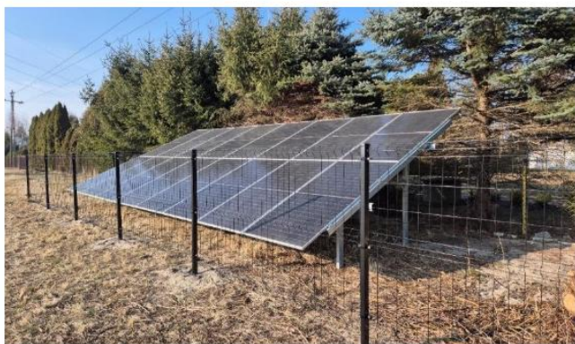
Farma fotowoltaiczna na przepompowni ścieków – przy ul. Małaszczyczej
