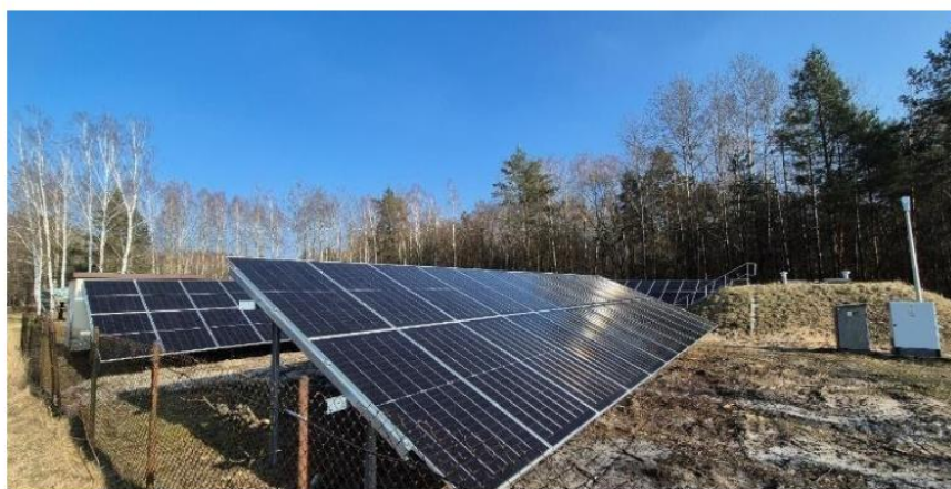
Farma fotowoltaiczna na studni głębinowej nr 1 Gliniak
