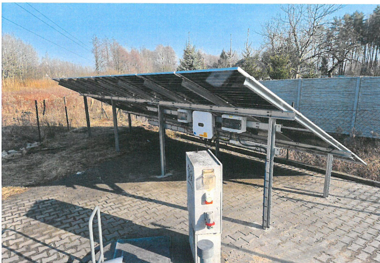
Farma fotowoltaiczna na przepompowni ścieków – przy ulicy Arynowskiej
