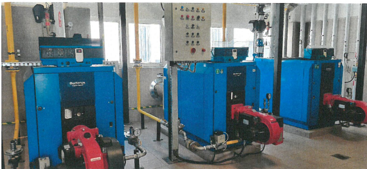
Kotłownia gazowa i biogazowa w ob. nr 15
