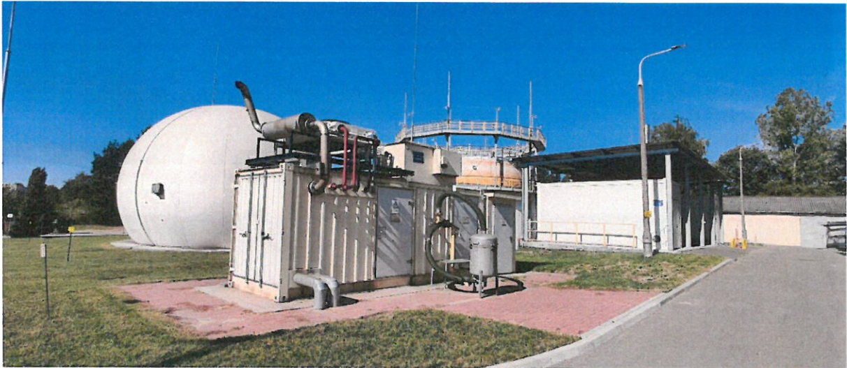
Agregat kogeneracyjny ob. nr 21d
