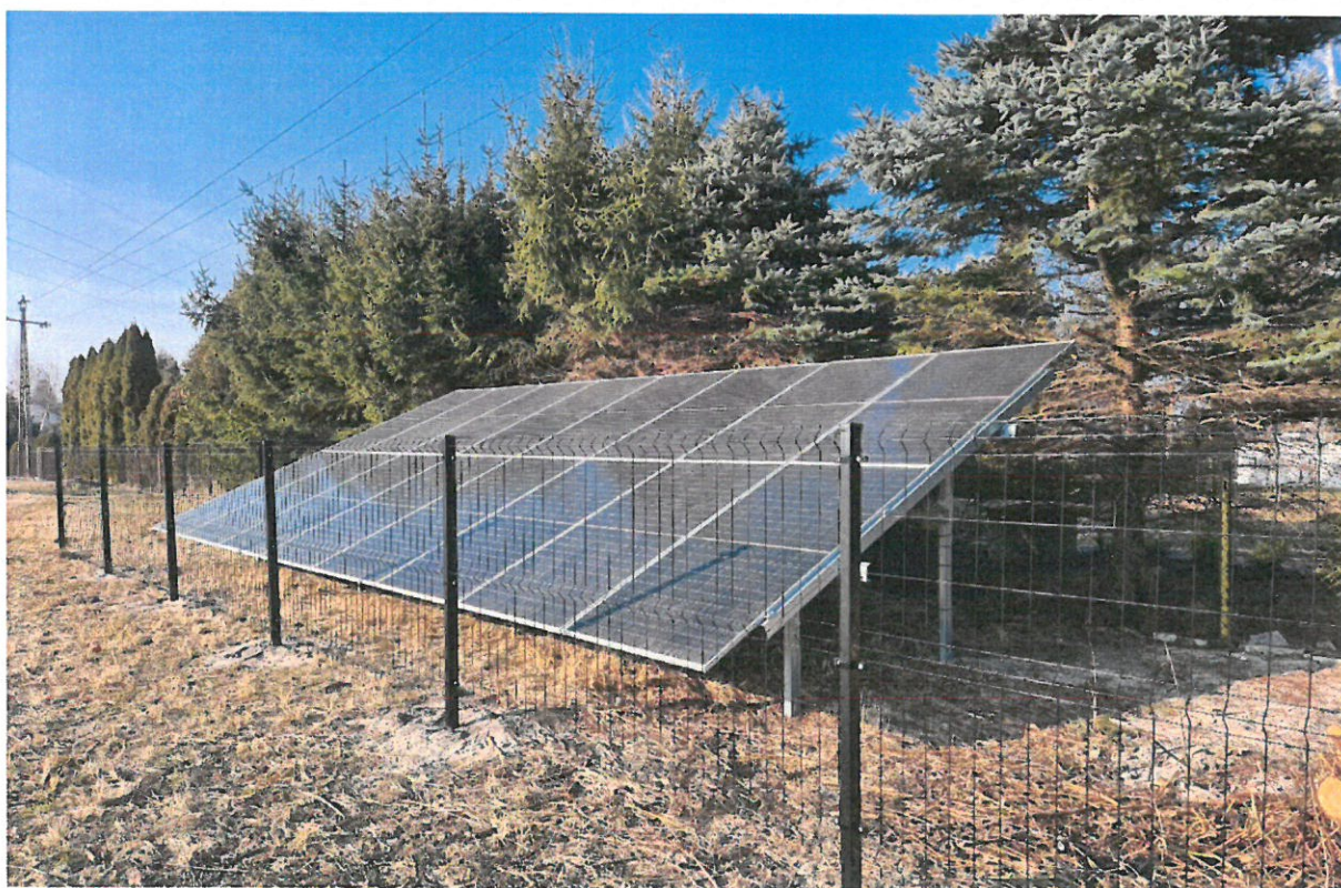
Farma fotowoltaiczna na przepompowni ścieków – przy ulicy Małaszczyczej
