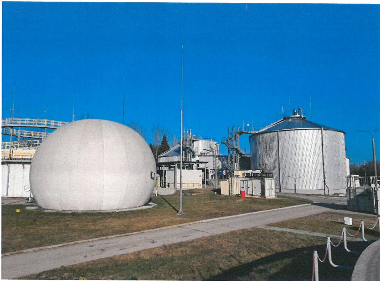
Widok urządzeń ciągu gospodarki biogazowej
