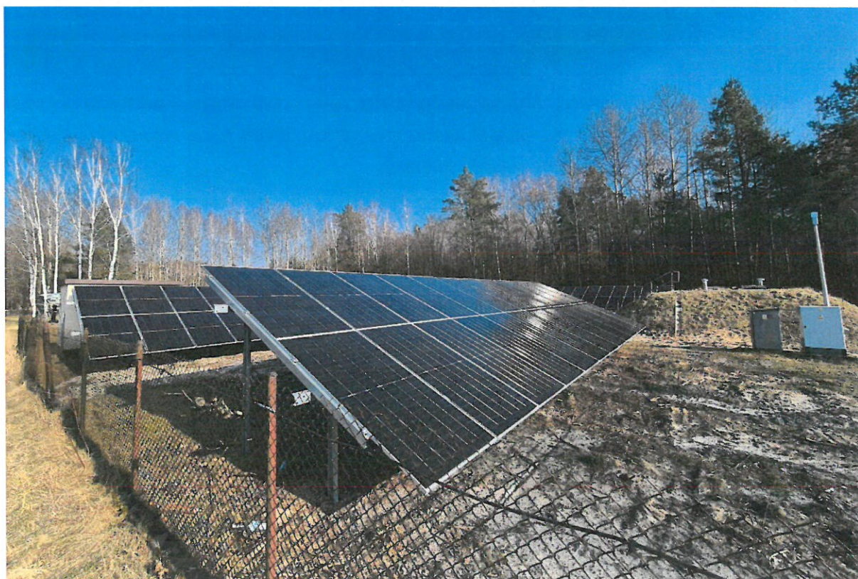
Farma fotowoltaiczna na studni głębinowej nr 1 Gliniak (pole)
