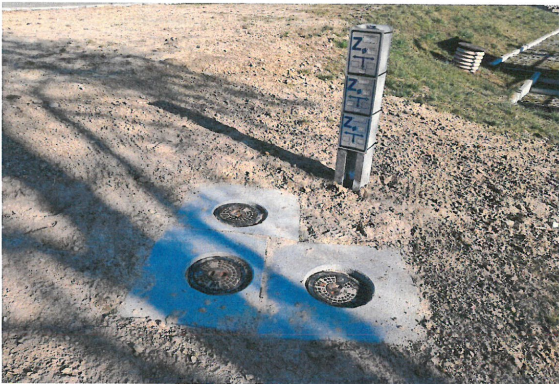
Zasuwy rozdziału na sieci w terenie
