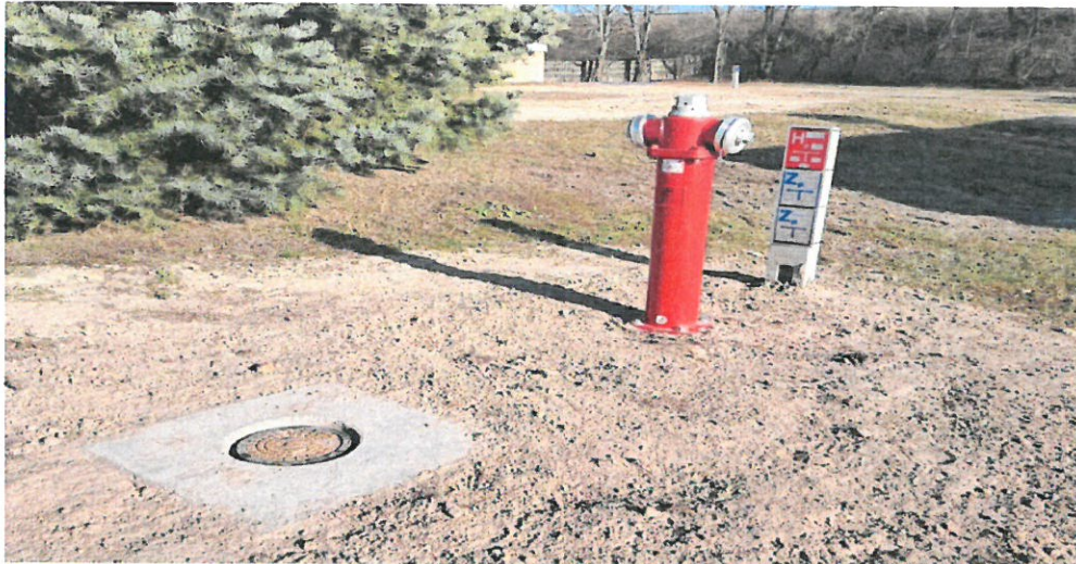
Hydrant na nowej sieci wodociągowej na terenie Oczyszczalni ścieków
