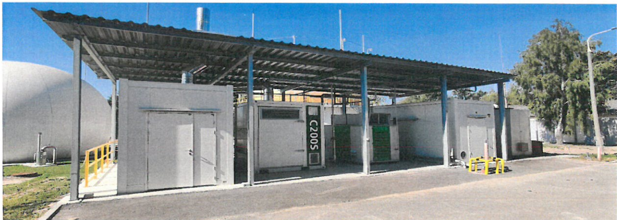
Instalacja uzdatniania biogazu wraz z Mikroturbiną ob. nr 20
