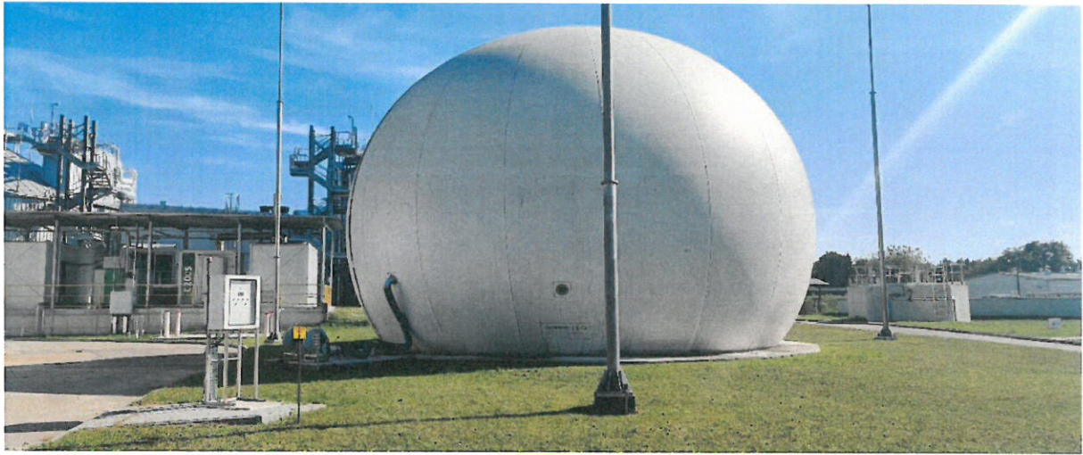
Zbiornik biogazu ob. nr 21b
