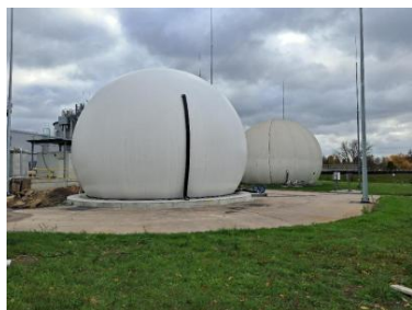
Zbiorniki biogazu ob. nr 21a (nowy pierwszy po lewej stronie) 21b (stary po prawej stronie)
