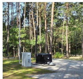
Nowa studnia głębinowa nr IX
