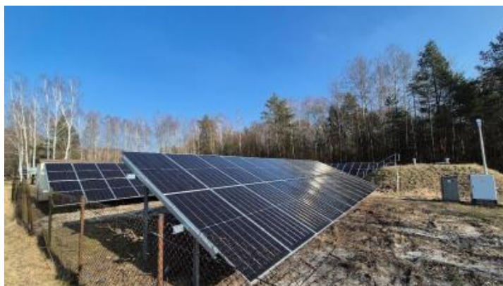
Farma fotowoltaiczna na studni głębinowej nr 1 Gliniak (pole)
